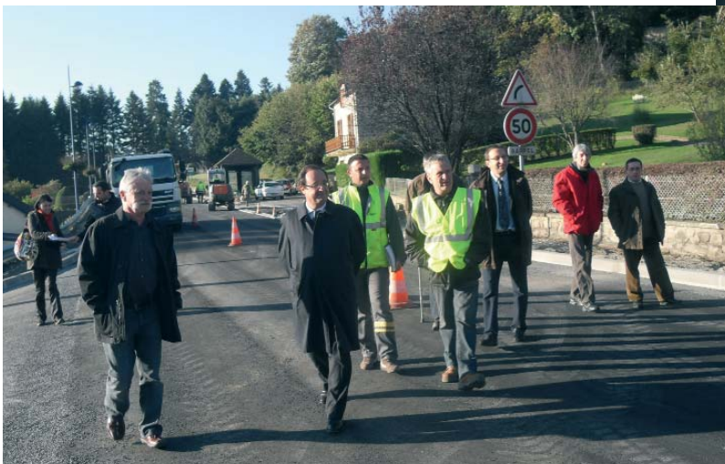
François Hollande et la commission municipale des travaux visitent le chantier Route d'Ussel
